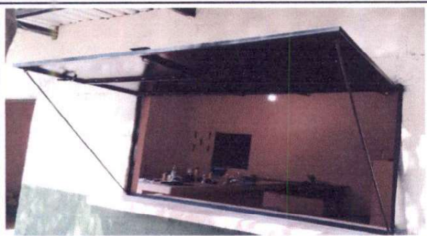
Foto 1: Sustitución de ventana de madera por metal abatible hacia arriba, incluye plancha de concreto revestida de azulejo.
