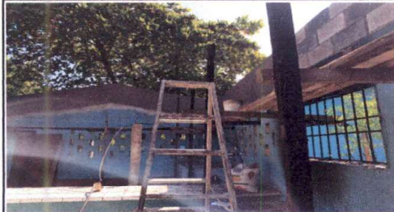
Foto1: Sustitución de lámina, por lámina troquelada aluzinc caibre 26 Sustitución de estructura de soporte de metal, por metal
