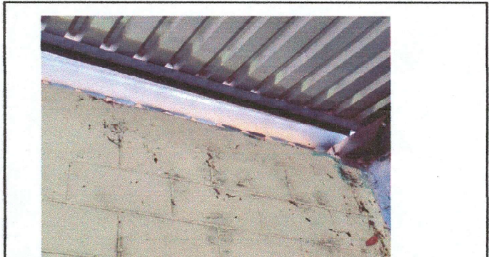
Foto 10: REPARACION DE CAPOTE Y REPARACION DE LÁMINAS DAÑADAS
