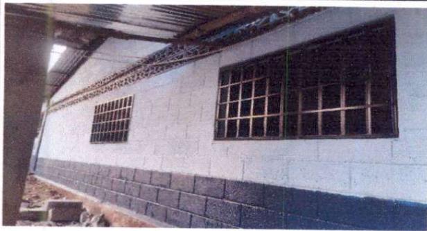
Foto 3: Ampliación de ventanas con balcon de metal en modulo 1
