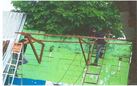
Foto 14: Sustitución de estructura, por lámina troquelada y soporte de metal, por metal en modulo de pila
