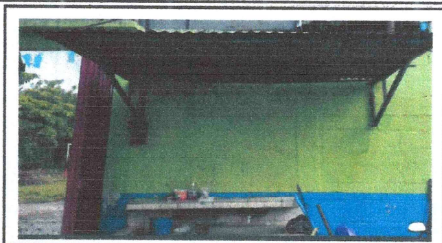
Foto 14: Sustrucción de estructura, por lámina troquelada y soporte de metal, por metal en modulo de pila
