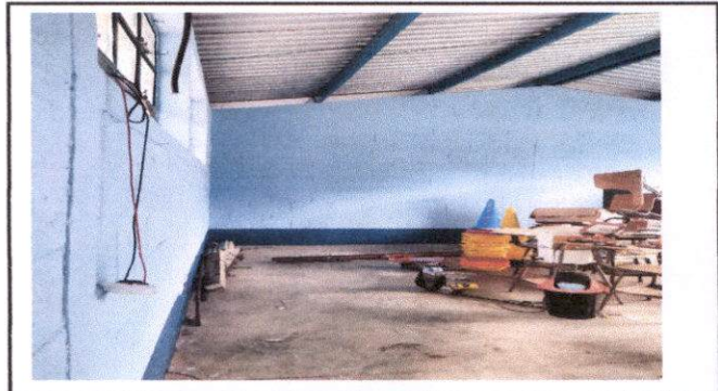
Cambio de lámina por picadura y oxidación
