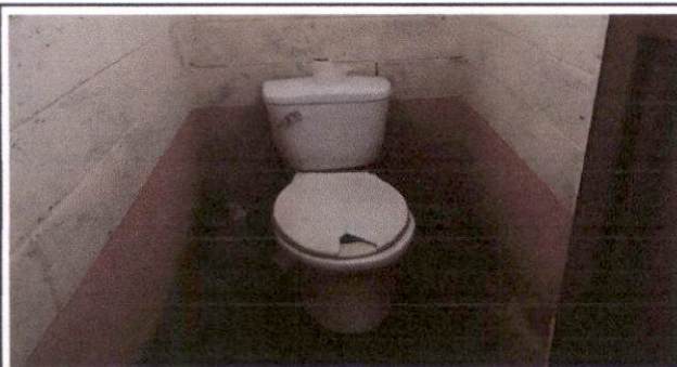
Sanitario en mal estado
