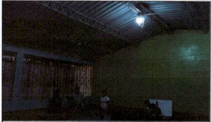
Foto 8: Solicitan aperturar un espacio en el muro perimetral que permita mejorar la ventilación e iluminación de aulas.
