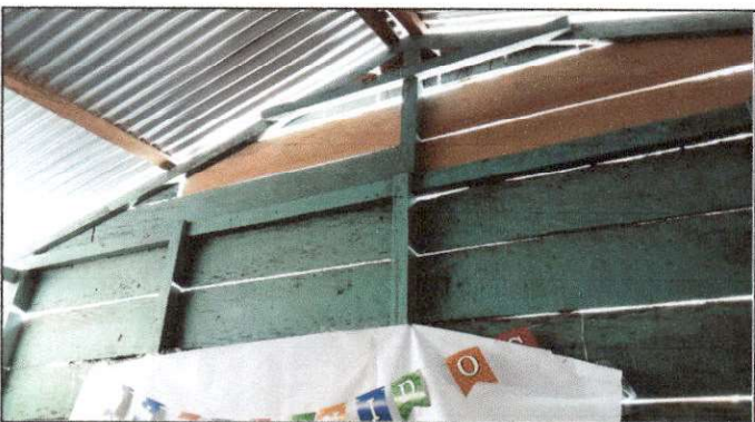
Foto 5: Estado actual de las aulas del establecimiento, solicitan el mejoramiento de aula hecha de madera.
