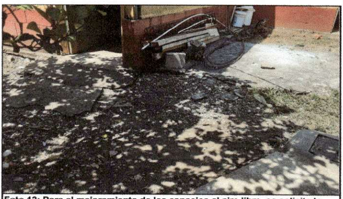
Foto 12: Para el mejoramiento de los espacios al aire libre, se solicita la fundición de torta de concreto en área de patio.
