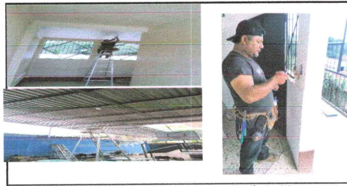
Foto 6: Reparación de sistema eléctrico modulo 1 y 2, sustitución de plafoneras, lámparas por focos ahorradores en el modulo 1 y 2, suministro de cableado eléctrico y sustitución toma corriente modulo 1 en area de cancha y modulo 2 en aula, interruptores
