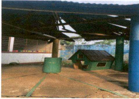
Sustitucion de estructura de soporte de madera por metal, sustitucion de lamina por lamina troquelada aluzinc calibre 26
