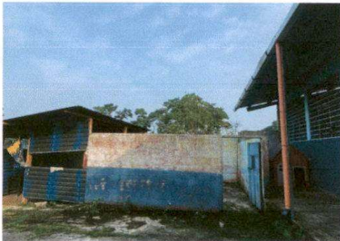
Sustitucion de estructura de soporte de madera por metal, sustitucion de lamina por lamina troquelada aluzinc calibre 26 area de cocina.
