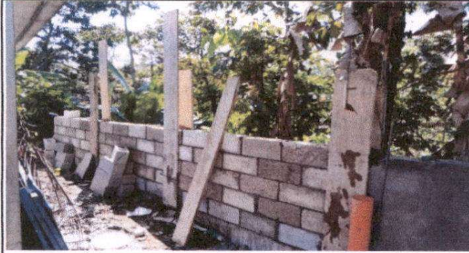
Foto1: Reparación de muro perimetral de bock con tubo gh y malla galvanizada, soleras intermedias y columnas.
