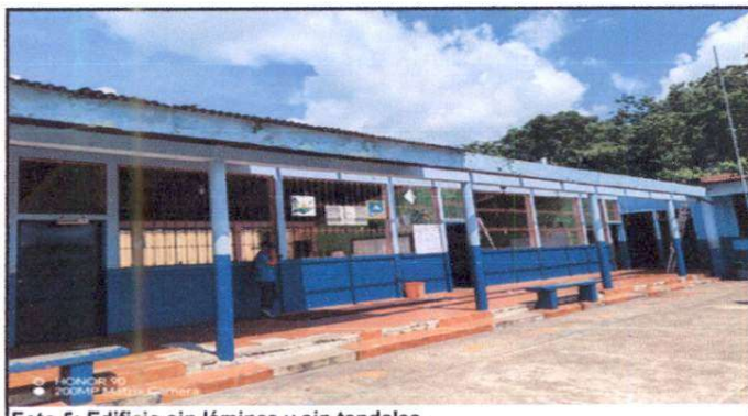
Foto 5: Edificio sin láminas y sin tendales.
