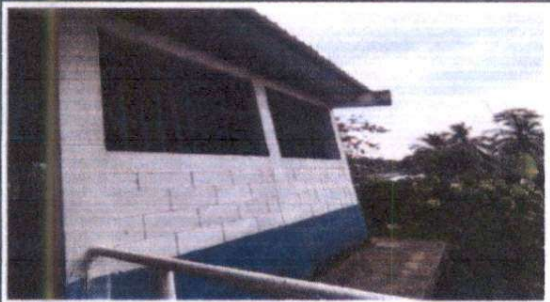
Foto 7: El salón de segundo primaria "B" no tiene ventanas y en época de lluvia se entra el agua, se requiere de instalación de ventanas de vidrio enfrente y atrás del mismo.
