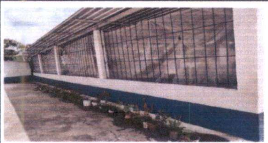
Foto 9: Los salones de cuarto primaria no tienen ventanas, provisionalmente se ha colocado naylon. Instalación de ventanas de vidrio y colocación de block en la parte de enfrente
