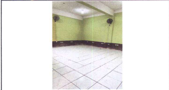
Foto 7: Sustitución de piso cerámico en mal estado por piso cerámico en laboratorio de computación.
