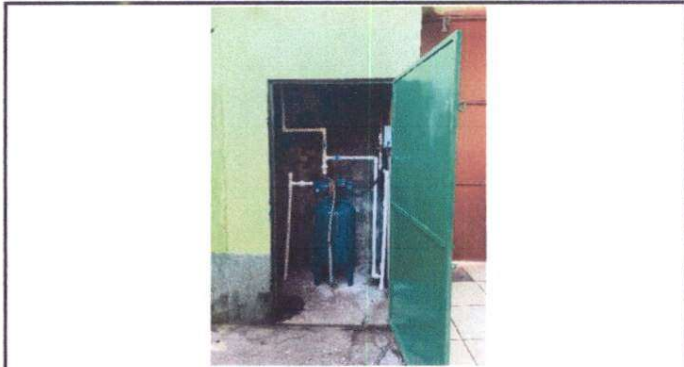
Foto 9: Sustitución de bomba hidronumática de 1 HP vertical (incluye accesorios y sustitución de instalación eléctrica)
