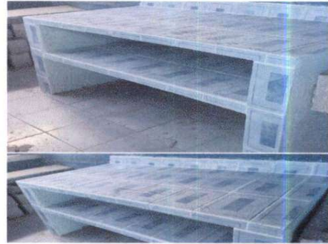
Sustitución de mesa de madera por plancha de concreto azulejado, para la cocina.
