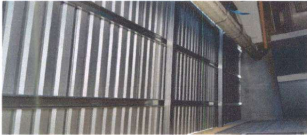
Foto 7: Techo de lámina enfrente de baño
