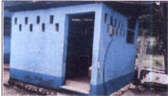
Foto2 COCINA: techo de lámina y madera está dañada urge cambio, también piso de cemento, balcones y puerta dañados y dan seguridad a la cocina.
