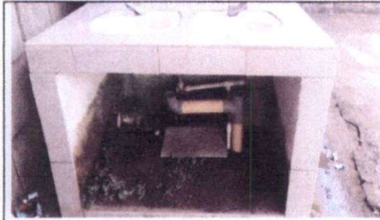
Foto 1: Lavamanos chorros no funcionan y mangueras que conectan con drenaje están podridas, se necesita puerta en la parte de abajo para guardar lo de limpieza, se harán cambios de accesorios en los lavamanos
