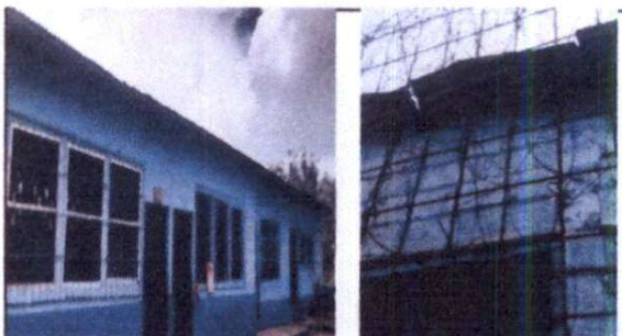
Foto 6 MÓDULO 2 AULAS: láminas dañadas muy antiguas, se sustituirá el techo de lámina por lámina troquelada calibre 26.
