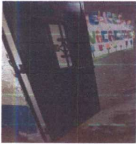
Foto 3: Cambio de puerta incluye chapa.
