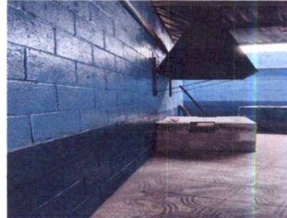
Foto 6: Sustrucción de estufa rural y plancha de metal
