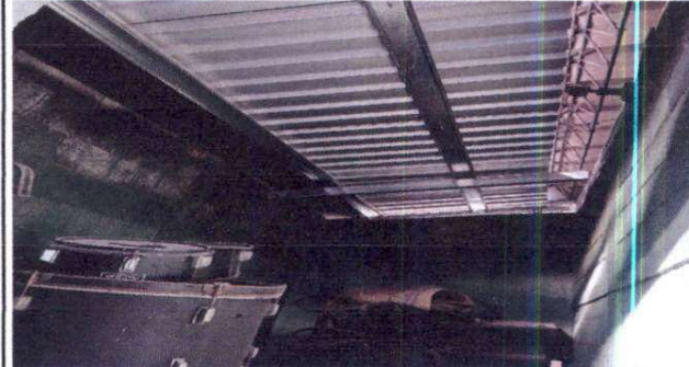
Foto 4: Sustitución estructura de soporte de metal por metal y techado de bodega de cocina
