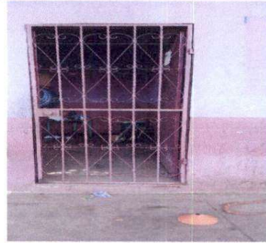
Foto 2: Sustitución de chapa yale derecha para salón de educación física
