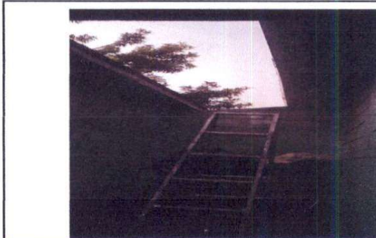
Foto 4: Sustitución estructura de soporte de metal por metal y techo de bodega de cocina
