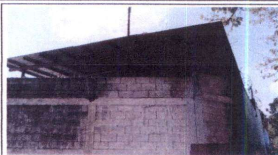
Foto 2: Cubierta de lámina acanalada por troquelada zintroalum, salón usos múltiples
