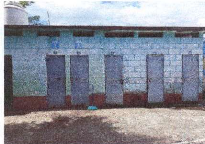
Foto 6: FOTOGRAFIA DEL ESTADO ACTUAL DE LAS PUERTAS DEL BAÑO
