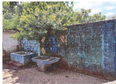
Foto 12: FOTOGRAFIA DEL ESTADO ACTUAL DE LA PINTURA DEL PATIO
