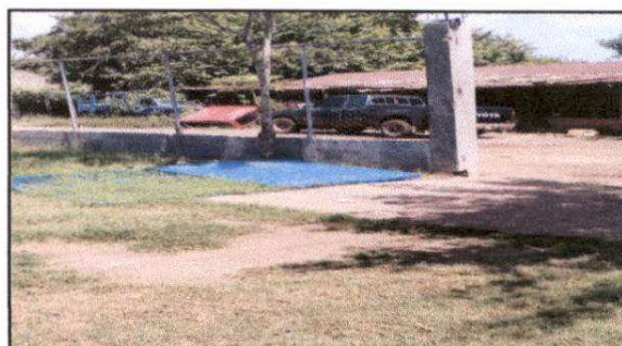
Foto 4: Mantenimiento en el portón de la entrada, ya que se el soporte que tenía no era el adecuado y se desprendió.
