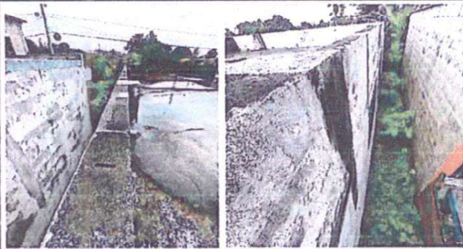
Suministro solera de concreto armado de 0.15 x 0.20 metros con marquesina y gota en cenefa, reparación de pared con suministro de cemento monocapa e impermeabilización de pared exterior e interior de
