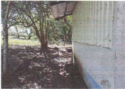
Foto 9: FOTOGRAFIA DEL ESTADO ACTUAL DEL CERCADO DE LA ESCUELA
