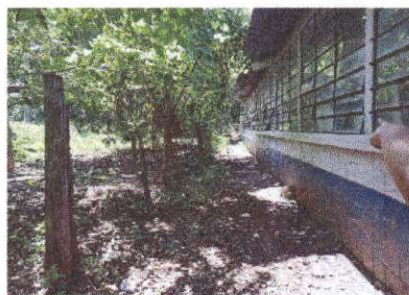
Foto 6: FOTOGRAFIA DEL ESTADO ACTUAL DEL CERCADO DE LA ESCUELA
