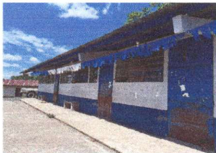
Foto 3: FOTOGRAFIA DEL ESTADO ACTUAL DE LAS PUERTAS DE LAS AULAS
