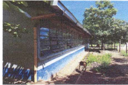
Foto 10: FOTOGRAFIA DEL ESTADO ACTUAL DEL CERCADO DE LA ESCUELA
