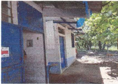
Foto 11: FOTOGRAFIA DEL ESTADO ACTUAL DEL CERCADO DE LA ESCUELA
