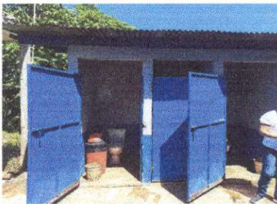
Foto 4: FOTOGRAFIA DEL ESTADO ACTUAL PUERTAS DE LOS BAÑOS
