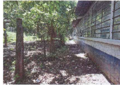
Foto 12: FOTOGRAFIA DEL ESTADO ACTUAL DEL CERCADO DE LA ESCUELA
