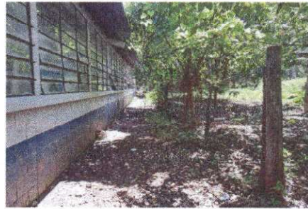
Foto 8: FOTOGRAFIA DEL ESTADO ACTUAL DEL CERCADO DE LA ESCUELA
