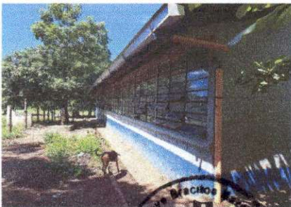
Foto 5: FOTOGRAFIA DEL ESTADO ACTUAL DEL CERCO DE LA ESCUELA
