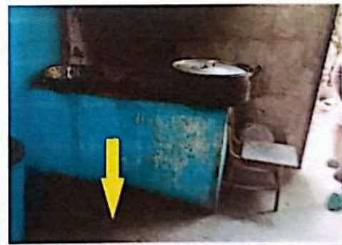
Foto 12: Piso en Cocina
