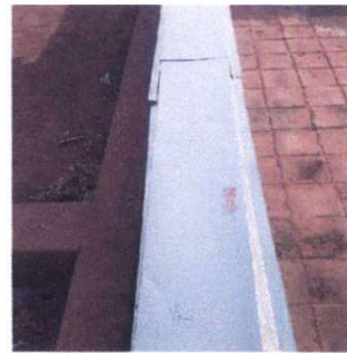
Filtración de agua por la terraza causada por daños a la infraestructura
