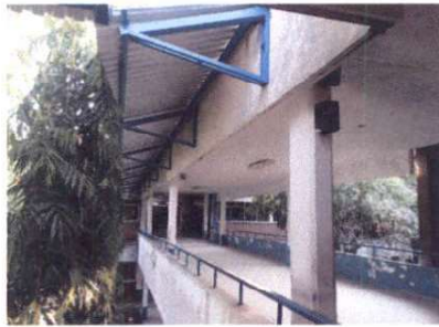
Filtración de agua por uniones de juntas metálicas inexistentes.
