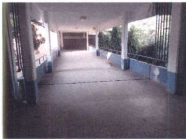
Filtración de agua a las aulas del Módulo I y II por el pasillo
