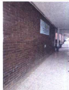
Filtración de agua en las paredes del pasillo de modulo I al módulo II
