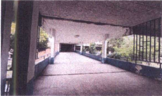
Filtración de agua por uniones de juntas metálicas inexistentes.
