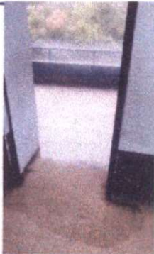
Filtración de agua a las aulas del Módulo I y II por el pasillo
