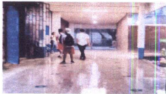
Filtración de agua por la terraza y uniones de juntas
