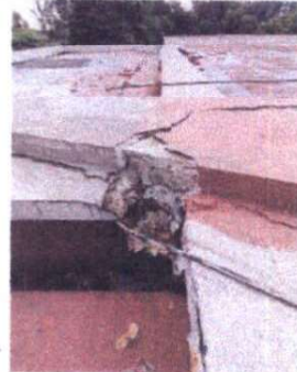
Filtración de agua por la terraza causada por daños a la infraestructura
