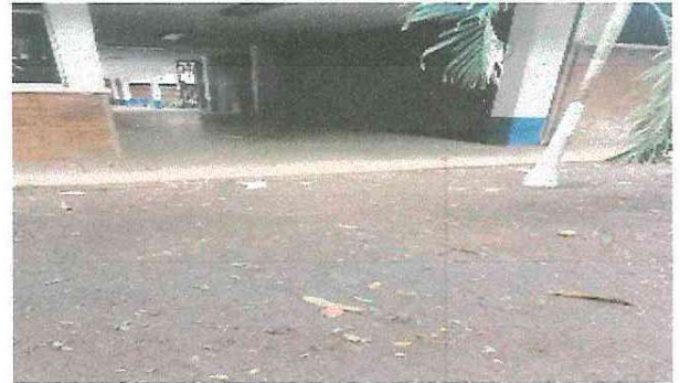
Foto 2: FOTOGRAFIA DONDE ILUSTRAMOS DONDE ENTRA EL AGUA PLUVIAL AL INSTITUTO POR NO CONTAR CON CUNETETA.
