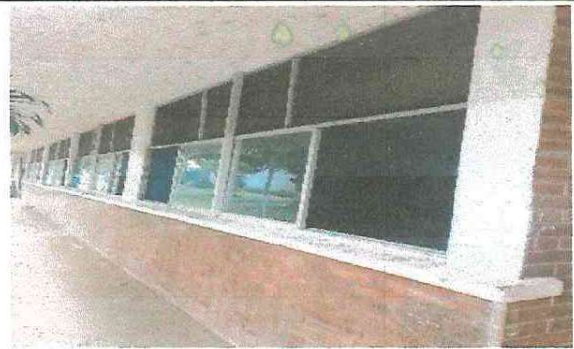
Foto 4: REFLEJAMOS AULAS DEL PRIMER MODULO QUE NO CUENTAN CON BALCON.
