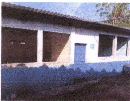
Sustitución de estructura de soporte de madera, por metal, aula modulo I.
