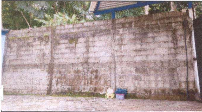
Foto 1: Por este espacio ingresaron la primera vez en este año 2024, los amigos de lo ajeno. A continuación en la foto 2 se observa la parte de atrás de este muro perimetral.
