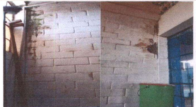
Foto 22: Módulo III. Filtración de agua salón 4.
