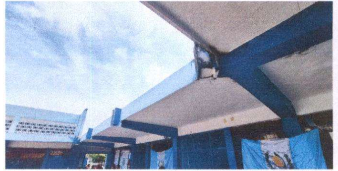
Foto 20: Módulo II. Filtración de agua en corredor.
