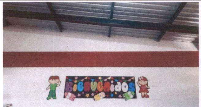
Foto 18: Módulo I. Filtración de agua salón 4.
