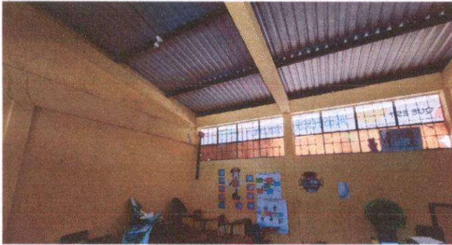
Foto 19: Módulo II: Filtración de agua salón 1.
