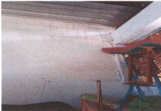
Foto 21: Módulo III. Filtración de agua salón 1.
