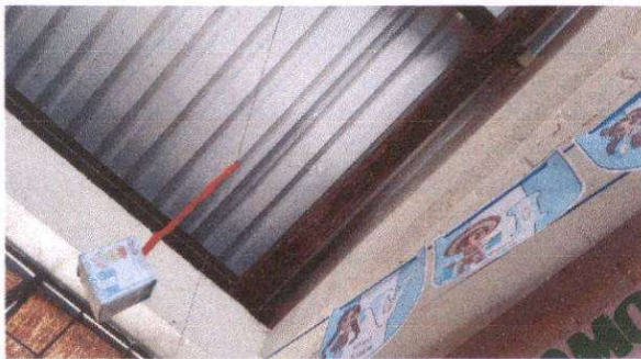
Foto 17: Módulo I. Filtración de agua salón 1.
