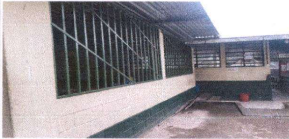
Foto 7: Suministro e instalación de balcones de metal y suministro e instalación de puertas de estructura metálica en aulas
