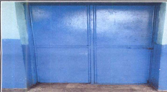
Foto 3: Reparación de puertas por óxido. 24/07/2024
