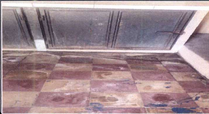
Foto 1: Hundimiento en el suelo de la cocina 24/07/2024
