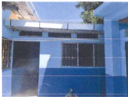
Foto 15: Finalización de pintura, instalación de canales, sustitución de techo y estructura metálica.
