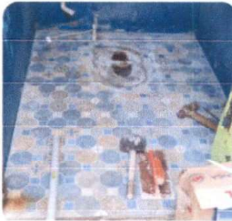
Foto 3: Sustitución de inodoro, sustitución de piso cerámico por piso cerámico y zócalo.
