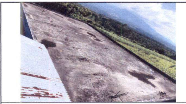
Foto 5: Impreмиabilización de loza
