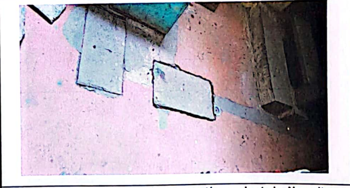
Foto 10: El piso del patio acumula agua y está en mal estado. Necesita remodelación y colocación de piso antideslizantes.
