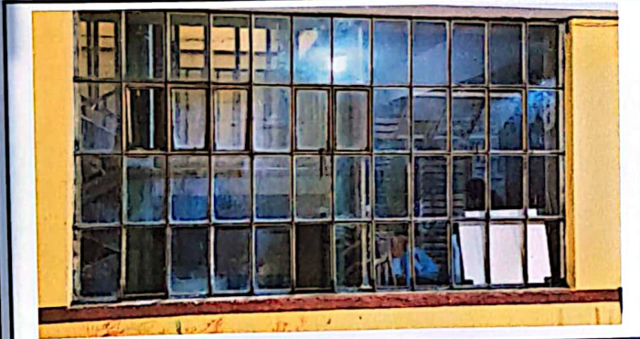
Foto 9: los marcos de metal están oxidadas y vidrios quebrados. Necesita reparación y pintada de marcos y reposición de vidrios.
