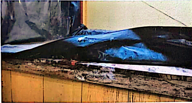
Foto 15: El techo de la bodega de madera se está pudriendo. Se necesita entarimado, anclaje de varilla y fundición con drenaje.
