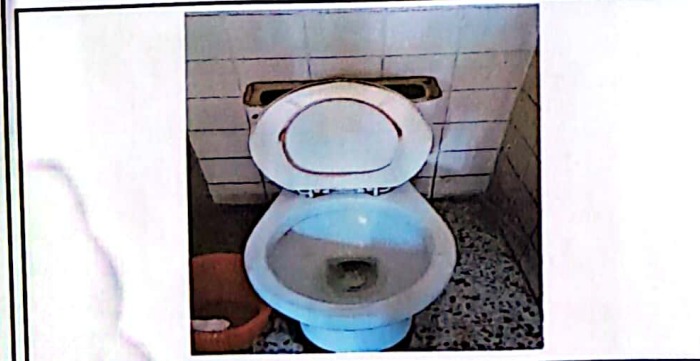
Foto 11: Los inodoros están en mal estado. Se necesita reemplazar por nuevos.
