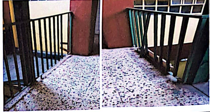
Foto 8: En el segundo nivel de la escuela, las barandas están oxidadas. Necesitan ser reemplazadas por nuevas.
