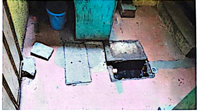
Foto 14: La fosa séptica se encuentra en mal estado. Se necesita limpieza y cambio de tubería.
