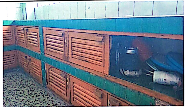
Foto 4: las puertas de madera para la alacena están flojas, se traban las llaves y en algunas se caen solas. Se necesitan sustituirlas por nuevas puertas de metal.
