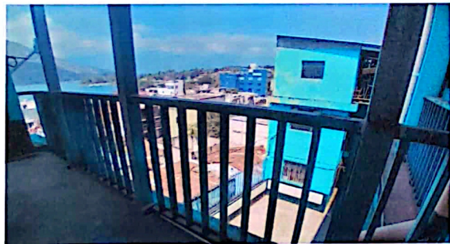
Foto 3: Baranda oxidada y en mal estado.
