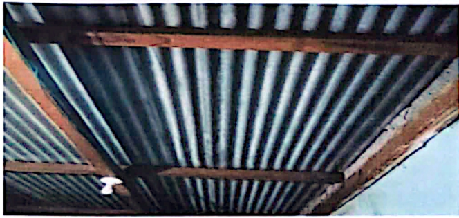
Foto1. Laminas deterioradas , tendales y reglas en mal estado .
