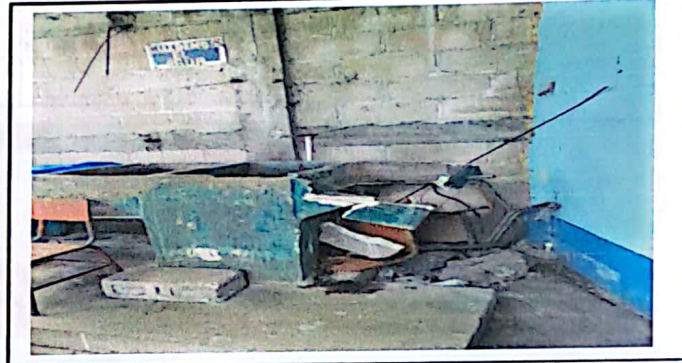
Foto 2: Esta pila no esta en condiciones de lavatrasos, al contrario esta en estado de contaminación.
