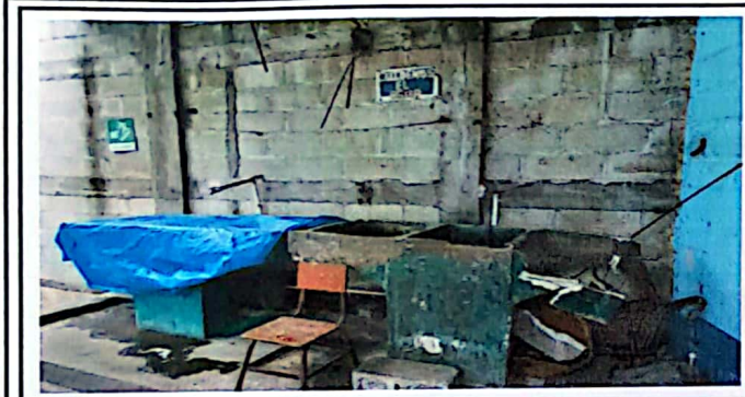
Foto 1: la condición de la pila se encuentra en deterioración y presenta contaminación ambiental y visual.
