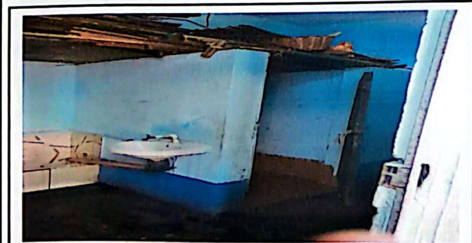
Foto 5: este sanitario se encuentra en condiciones precarias donde pueda afectar la situación de higiened de los alumnos.
