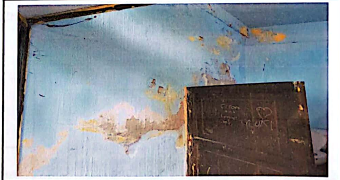
Foto 4: Esta pared de los sanitarios presenta mayor grado de contaminación a los alumnos o quienes utilizan.
