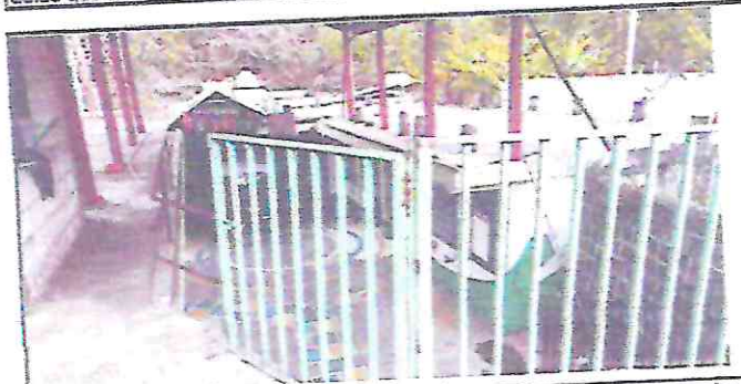
Las barandas del segundo nivel esta en muy mal estado y se quiere reemplazar varias piezas y se esta moviendo, por lo que se quiere soldarlo bien y pintarlo para evitar cualquier accidente.
