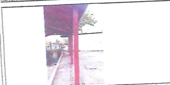
En la fotografía se observa la estructura de techo que esta en mal estado y se esta picando su base, antes de que caida al suelo y que causa daño se quiere reemplazar varias piezas y cambiar las laminas para que tenga mas resistencia.
