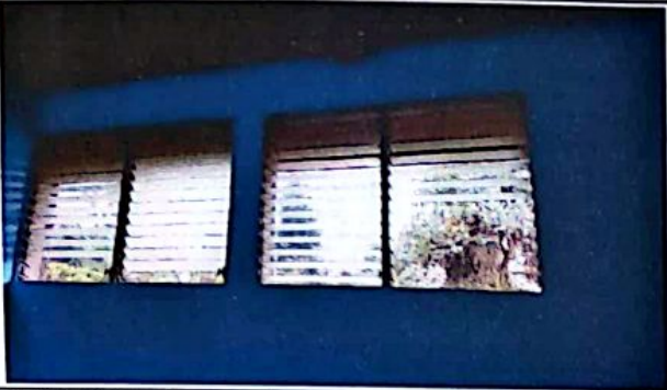
FOTO 1: Estas ventanas son de un gran riesgo propensas a caer sobre los niños porque son de paleta y ya llevan años y ya no se pueden cerrar porque se han oxidado.
