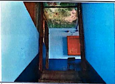
foto 6. Esta puerta de metal ya no se cierra y se han quebrado parte de los metales, es necesario cambiarlo.
