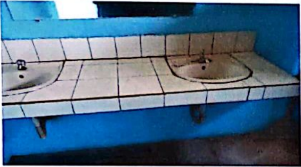
foto 3. Los lavamanos están en mal estado, es necesario cambiarlos para un mejor funcionamiento.
