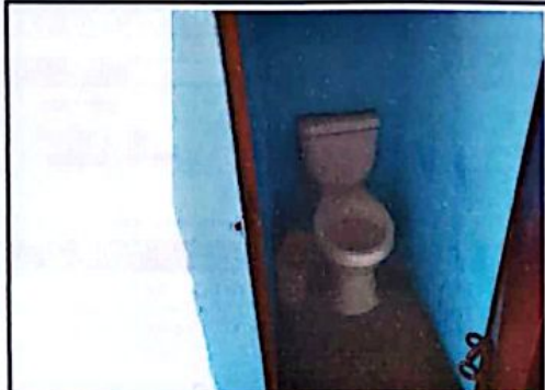
foto 2: Los inodoros ya no funcionan de la manera correcta, los niños tienen que echar agua a través de un galón.
