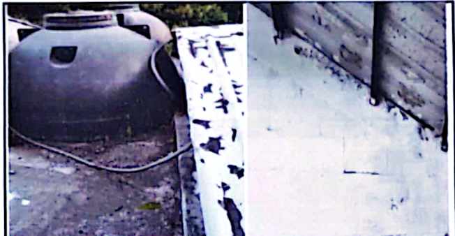
Foto 8: losa en mal estado.
