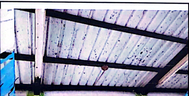
Foto 6: Estructura de techo oxidadas.
