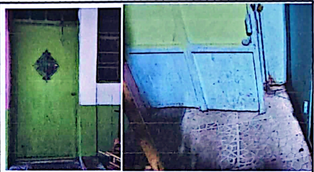
Foto 2: puertas oxidadas de las aulas y bodegas.
