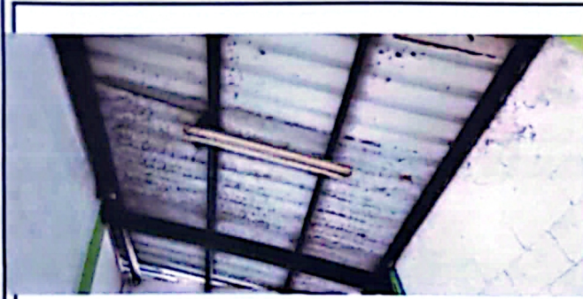
Foto 7: cubierto de láminas deterioradas.
