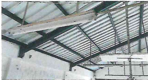
Foto 1: Instalación eléctrica segundo nivel.
