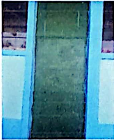
Foto 3: Puertas en mal estado, que necesita cambio y cerradura nueva
