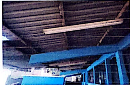
Foto 4: estructura metalica en mal estado, oxidado, necesita mantenimiento.
