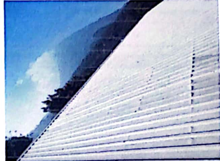
Foto 2: las laminas estan dobladas, agujerados.
