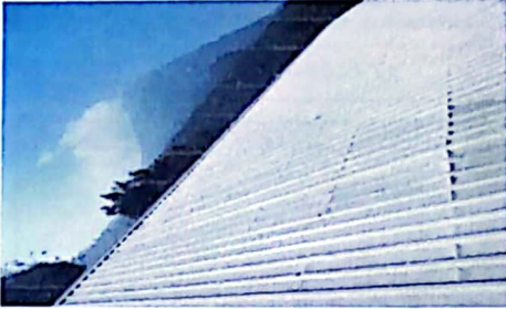
Foto 1: Las laminas actuales del techado se encuentra en mal estado, tiene agujeros.
