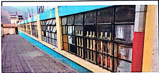
Foto 2: Ventanas deterioradas, crea mucho calor en las aulas.
