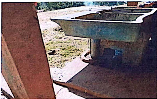
Foto 5: Pila despintada y mal ubicada.
