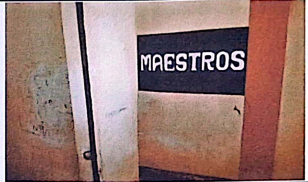
Foto 2: ubicación de los sanitarios mal diseñados.
