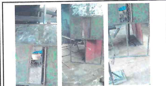
FOTO 3: CAMBIO PLANCHAS DE METAL DE PUERTAS EN PARTE INFERIOR DEBIDO A CORROSION
