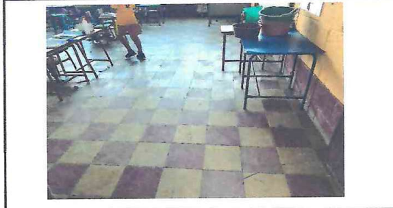
FOTO 2: El piso de las 3 aulas existente en mal estado.
